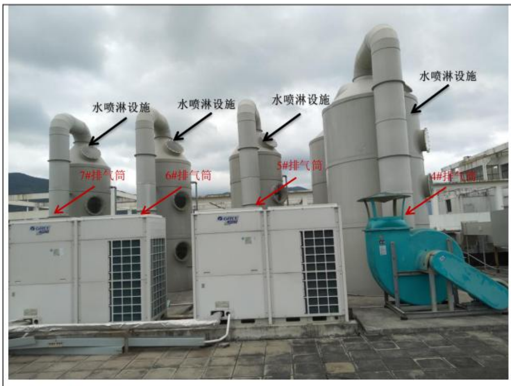
图 3.1-2 无机废气处理设施
