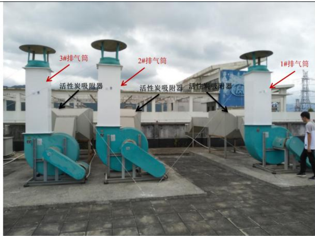
图 3.1-1 有机废气处理设施
