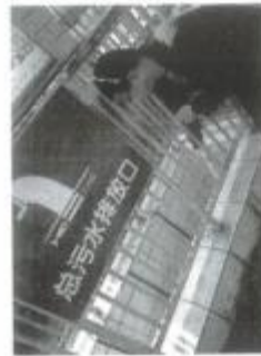
★2 设施后排放口
