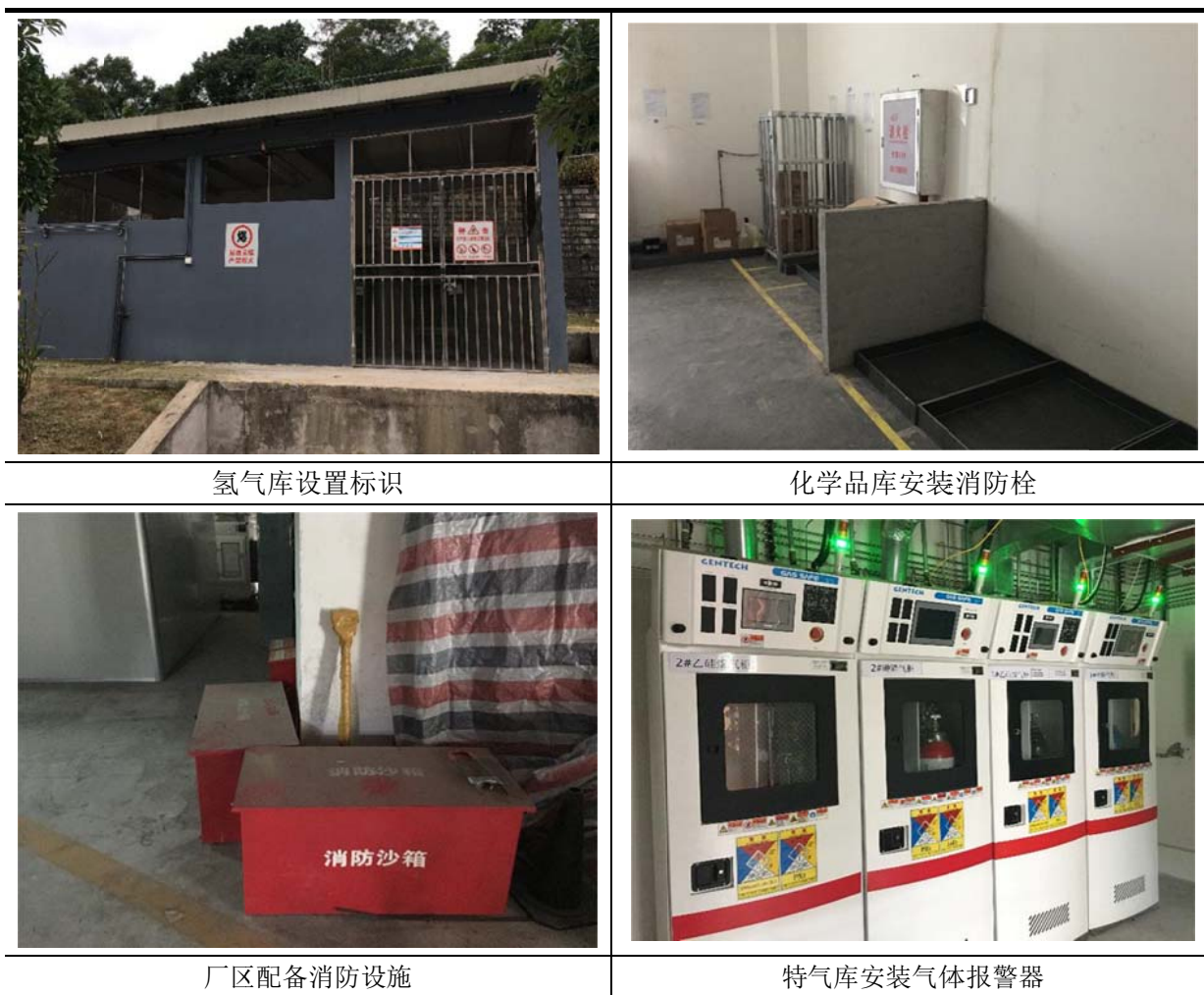
图 4.5-1 现有厂区已采取的风险防范措施
